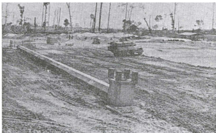
รูปที่ 9-10 งานก่อสร้างท่อระบายน้ำจากอ่างเก็บน้ำ
